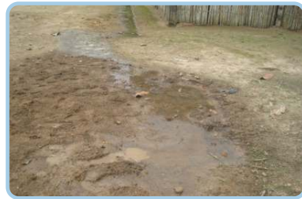
Filtración de agua por ruptura de tubería
