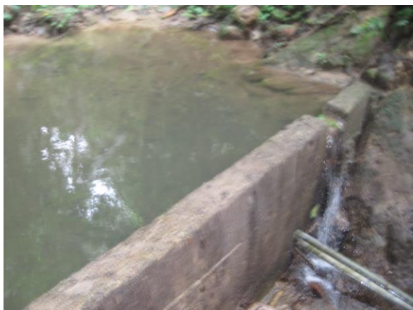
Foto 1. Captación de agua de consumo
