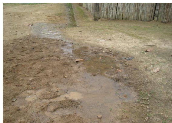
Foto 4. Filtración de agua por ruptura de tubería.
